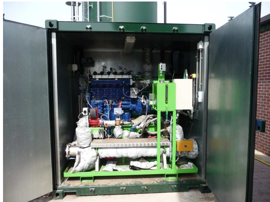
WKK met rail/stekker constructie
