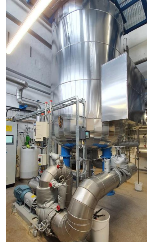
E-boiler bij Avebe in Malmö
